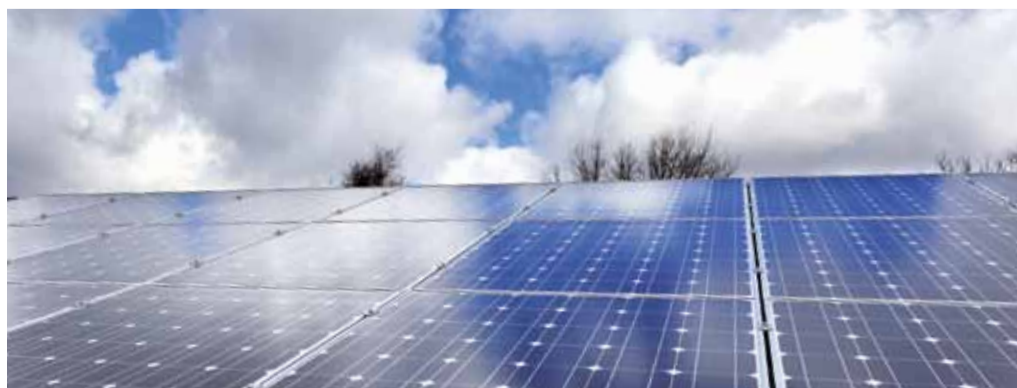
Die Solaranlage Auf der Wegscheid erwirtschaftete 2011 insgesamt 118.500 Kilowattstunden Strom.
