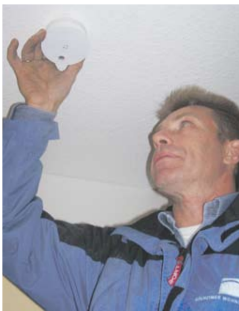
Sicher ist sicher: In allen Häusern und Wohnungen der MWB wurden Rauchmelder installiert.
